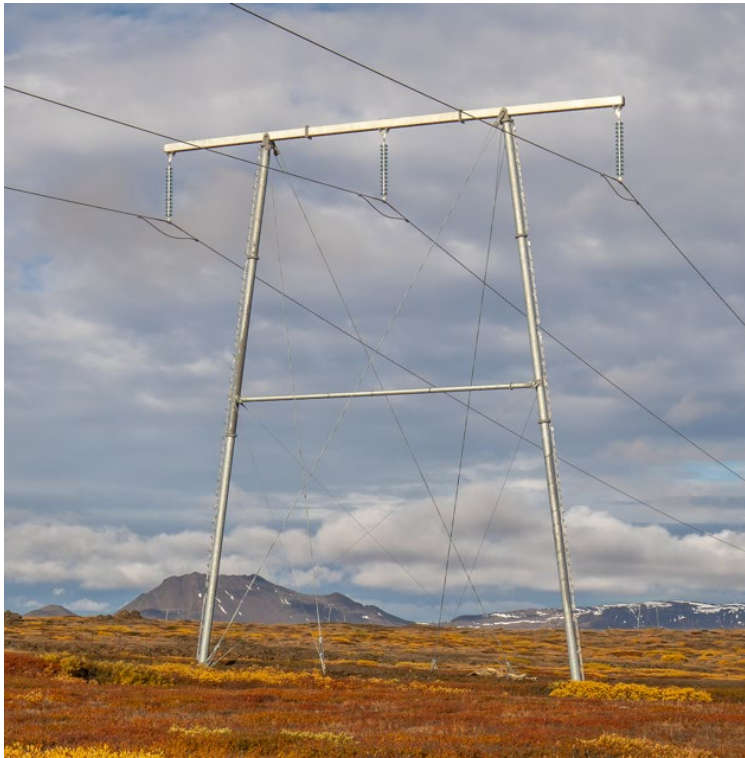
Mynd 3. Stagað burðarmastur eins og verður notað. Mynd frá 220 kV Kröflulínu 3
