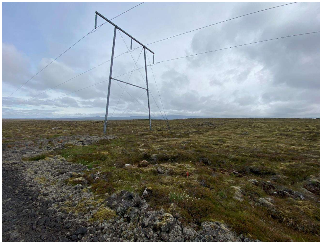
Mynd 7 Röramöstur Suðurnesjalínu 1, mastur 85.
