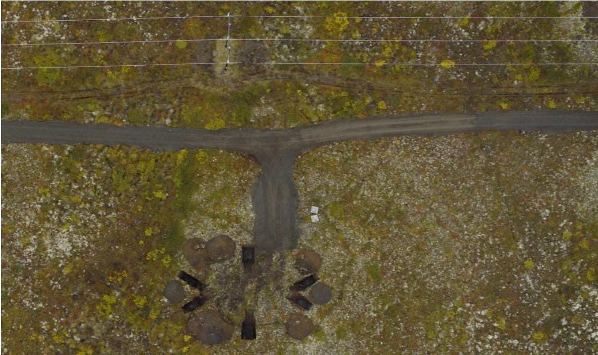
Mynd 6.9 Gröftur fyrir undirstöðum og forsteyptar undirstöður á framkvæmatíma á masturstæði í Kröflulínu 3.
